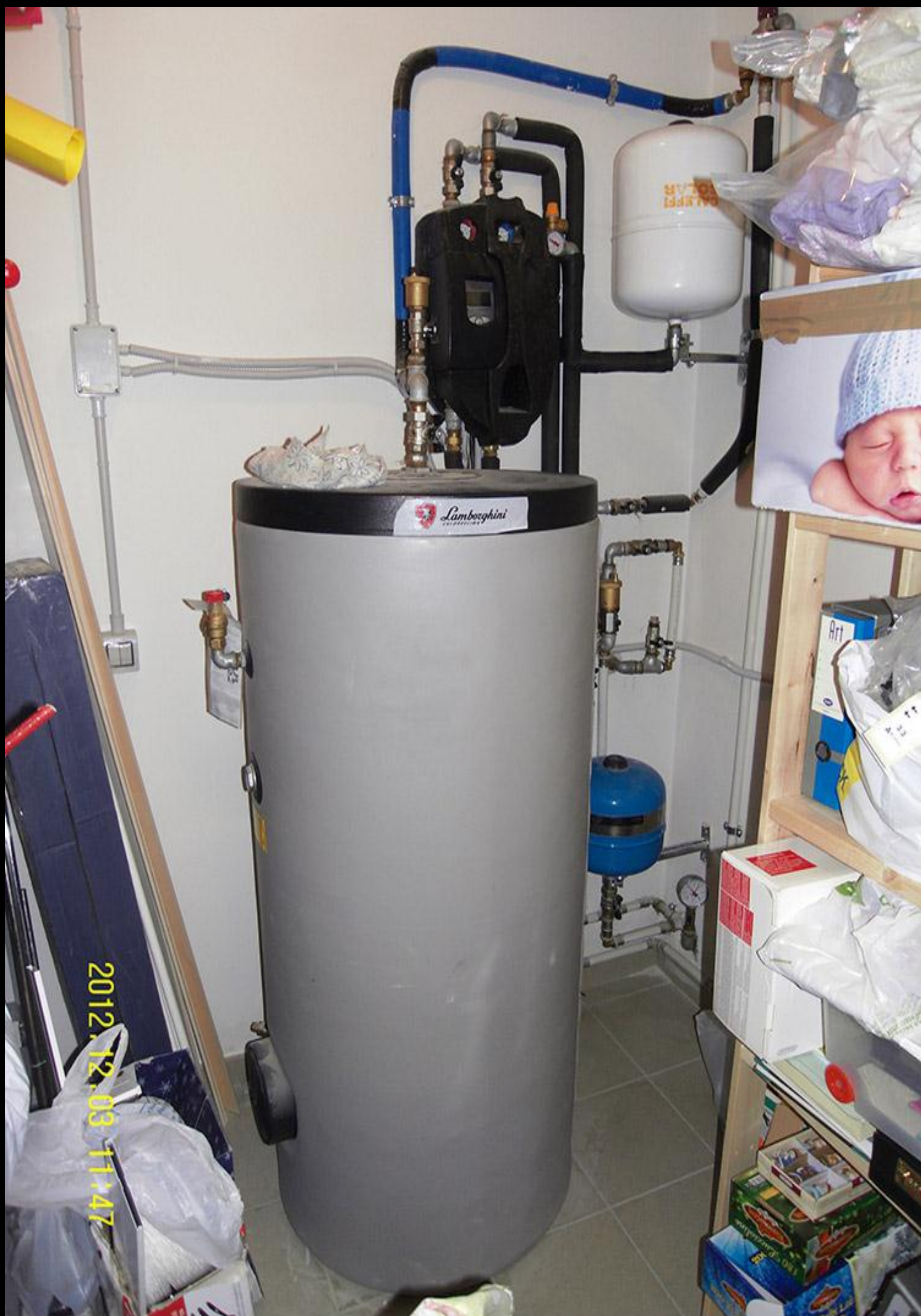
Impianto solare termico collegato ai pannelli solari sul tetto IMPIANTO PER UNA SINGOLA ABITAZIONE
