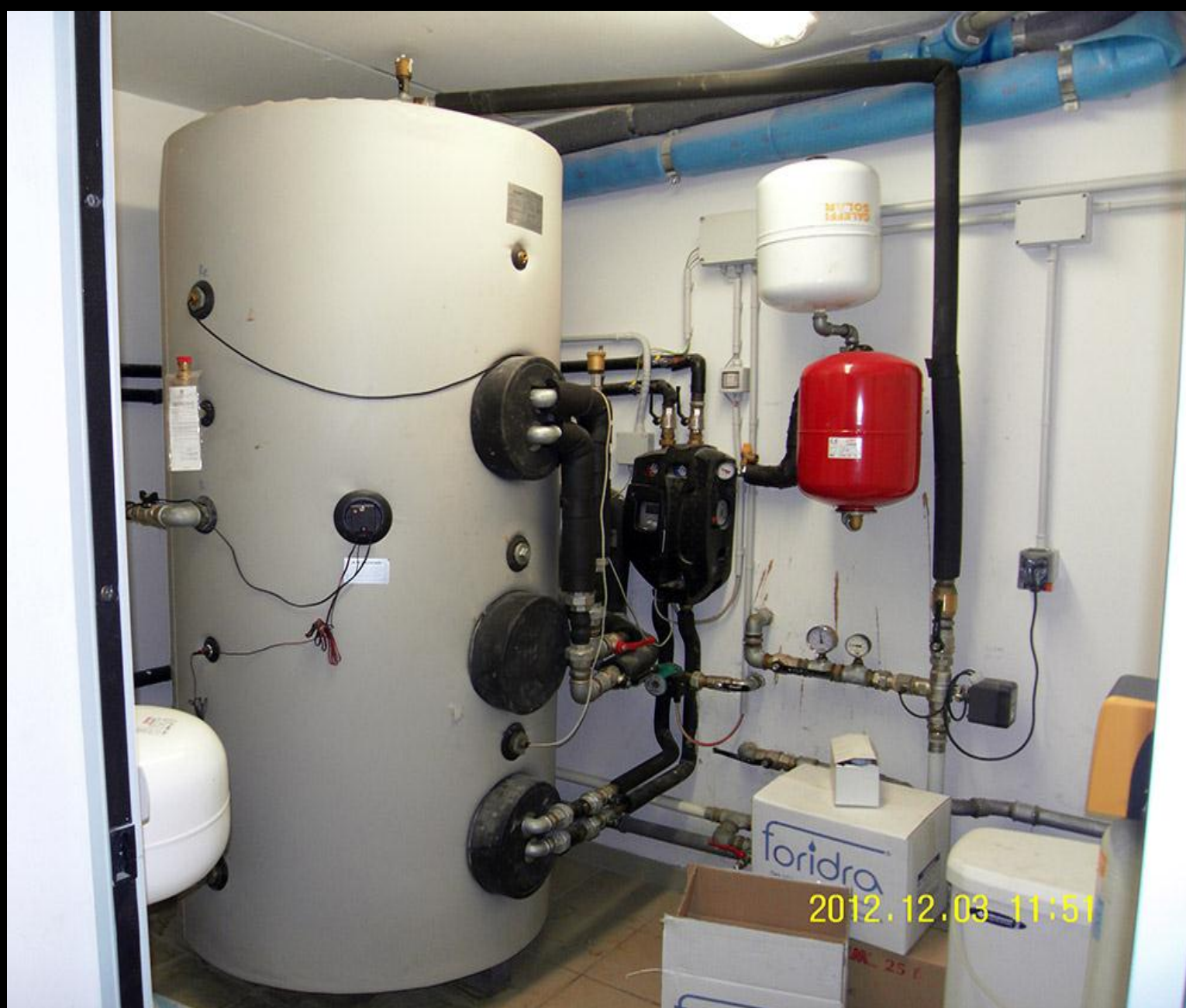
Impianto solare termico in stanza tecnica condominiale collegato ai pannelli solari sul tetto IMPIANTO CONDOMINIALE DA 4 UNITA' CON CONTACALORIE SINGOLE
